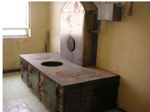
Der neue Herd mit Warmwassertank
