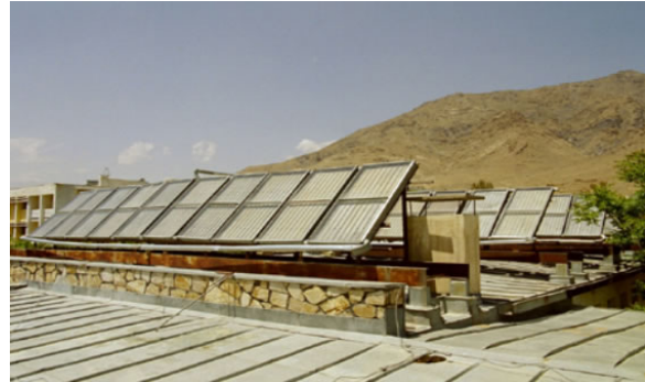
Warmwasseranlage auf dem Dach
